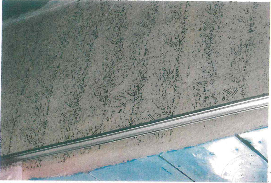
Harım duvarındaki çatlaklar.
